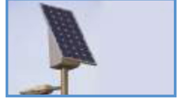
d) Güneş enerjisi aydınlatma direkleri
